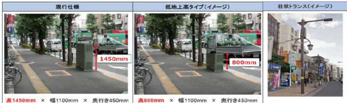
図-6.3 地上機器のコンパクト化イメージ及び柱状トランス
