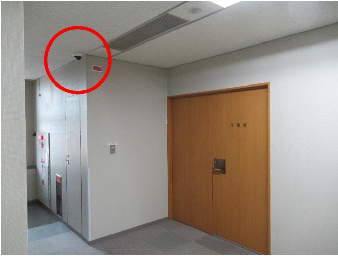
防犯カメラの設置（3階）
