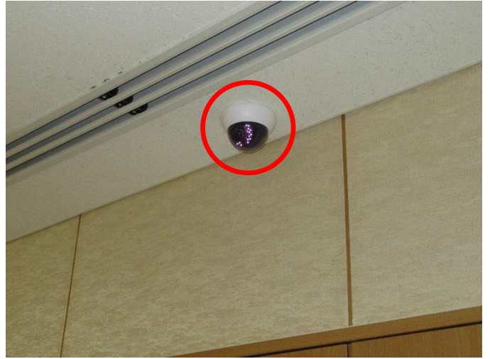
防犯カメラの設置（市長室）
