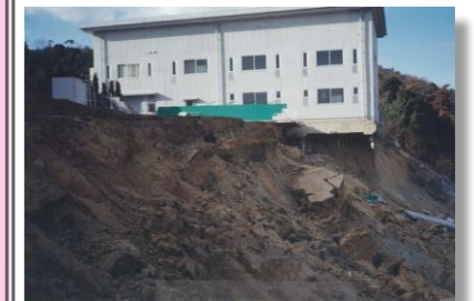
阪神・淡路大震災による盛土崩落
