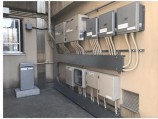
蓄電池・パワーコンディショナー等
