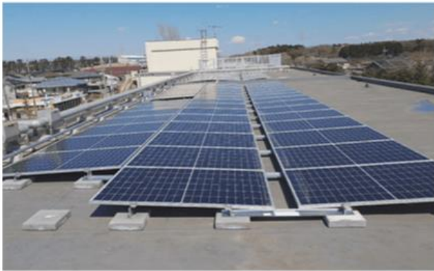
太陽光パネル
