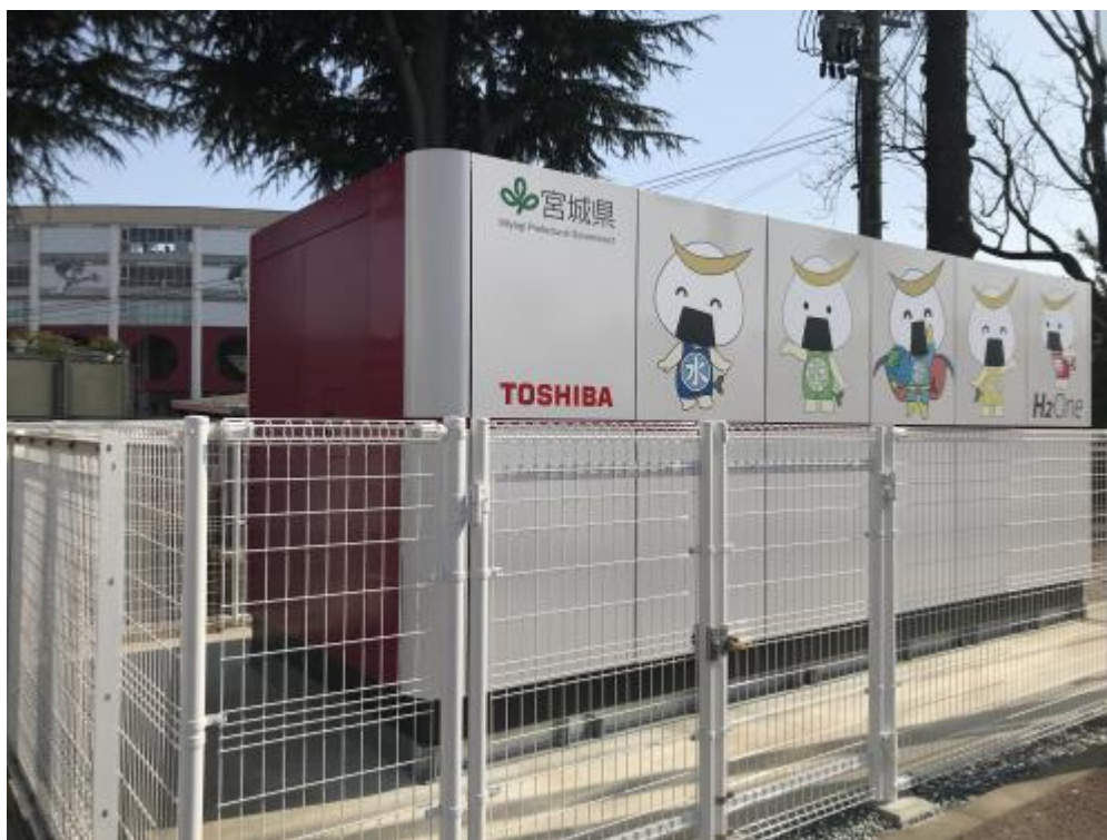
出典：楽天生命パーク宮城に水素エネルギー発電設備を導入しました（宮城県 HP）
