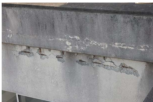
鉄筋腐食でコンクリートが破壊された例(爆裂)
