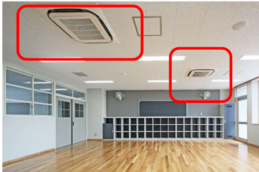
上尾中学校の教室エアコン
