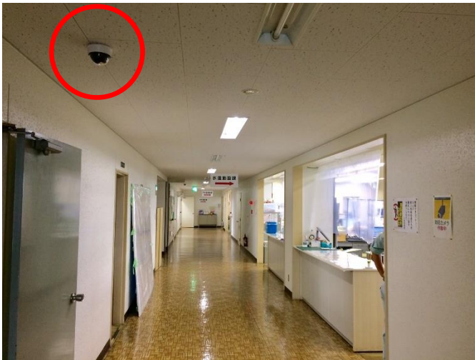
防犯カメラの設置（水道施設課）
