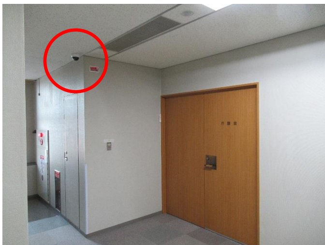
防犯カメラの設置（3階）
