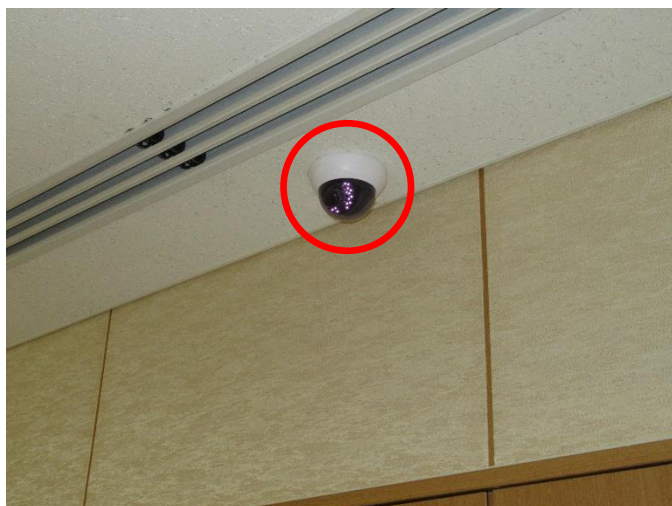
防犯カメラの設置（市長室）
