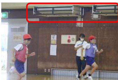
体育館のエアコン
