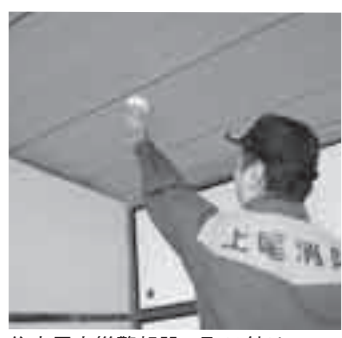
住宅用火災警報器の取り付け
