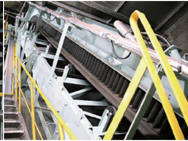
復旧後のベルトコンベア
