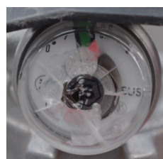
× 指示圧力計の損傷
