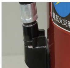
× 消火薬剤の漏れ
