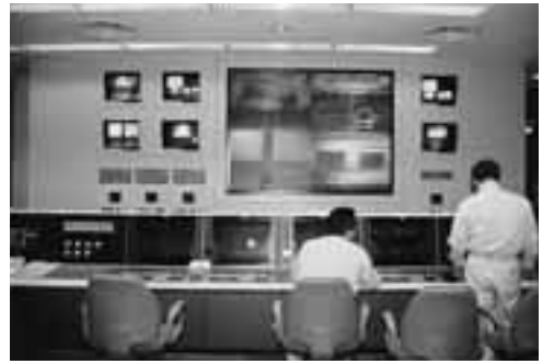
西貝塚環境センター内中央制御室
