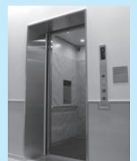
2階エレベーター
