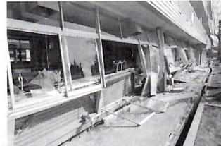
東日本大震災での本宮市被害状況(本宮第二中学校倒壊)
