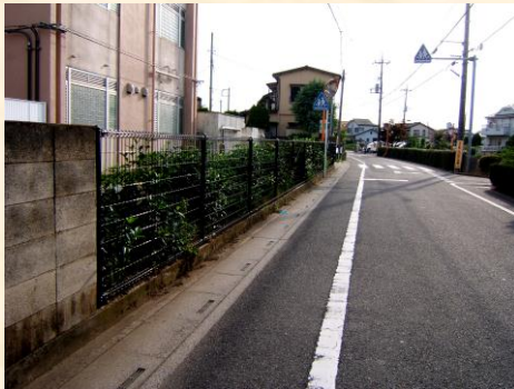
見通しの悪いブロック塀と通学路
