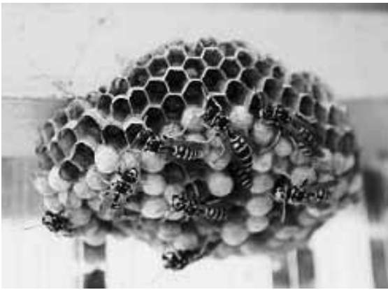
軒下に作られたスズメバチの巣
