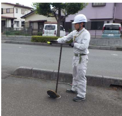
仕切弁の開閉操作
