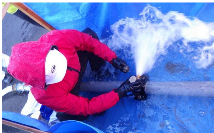
漏水が溜まり徐々に水かさが増す
