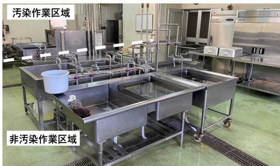
↑ 非・汚染作業区域との部屋分けがされておらず下処理室が未設置の給食施設
